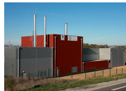
Si le Plan climat énergie territorial confirme la volonté de la Communauté d'agglomération et de ses communes d'amplifier leur action dans ce domaine, elles n'ont pas attendu pour réaliser des opérations de développement durable : ici, une des chaufferies à bois de Castres-Mazamet.
